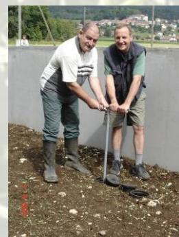
Oeffnen der Schieber Montricher (VD) August 2007
