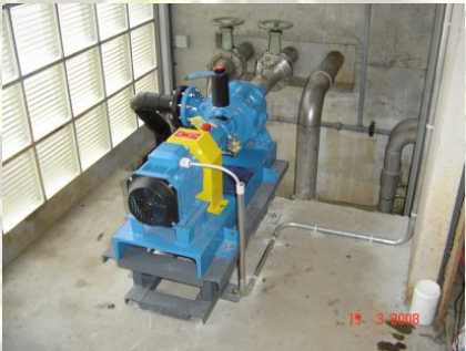
Pumpe für Klärschlamm-Zuführung
